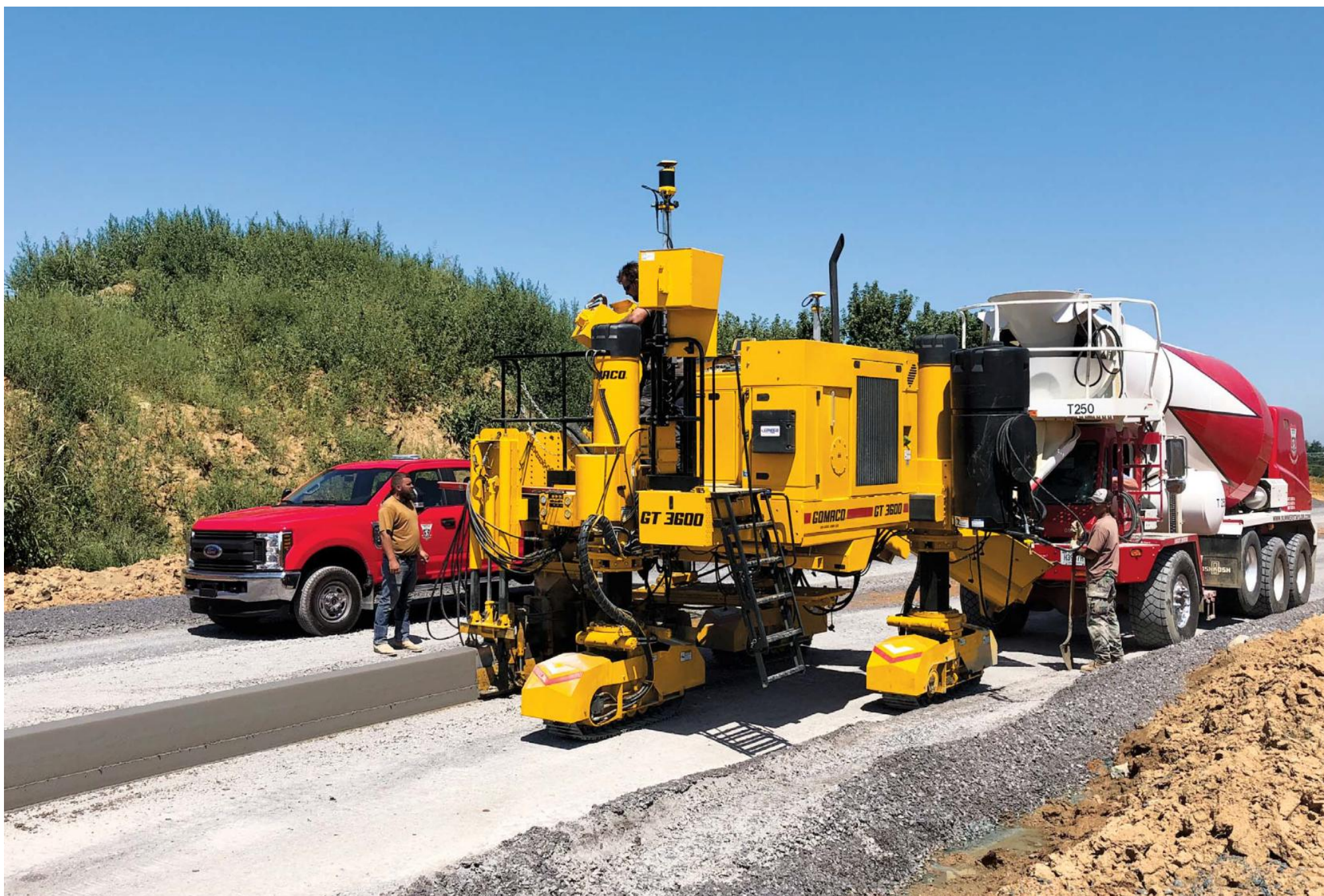
GOMACOリモート診断 (GRD)を搭載したエクストリームGT-3600が、18インチ (457mm) のスタンドアップカーブを打設しています。GRDを使うと、スマートフォンやパソコンから遠隔でのアップデートやフリート管理を行うことができます。
