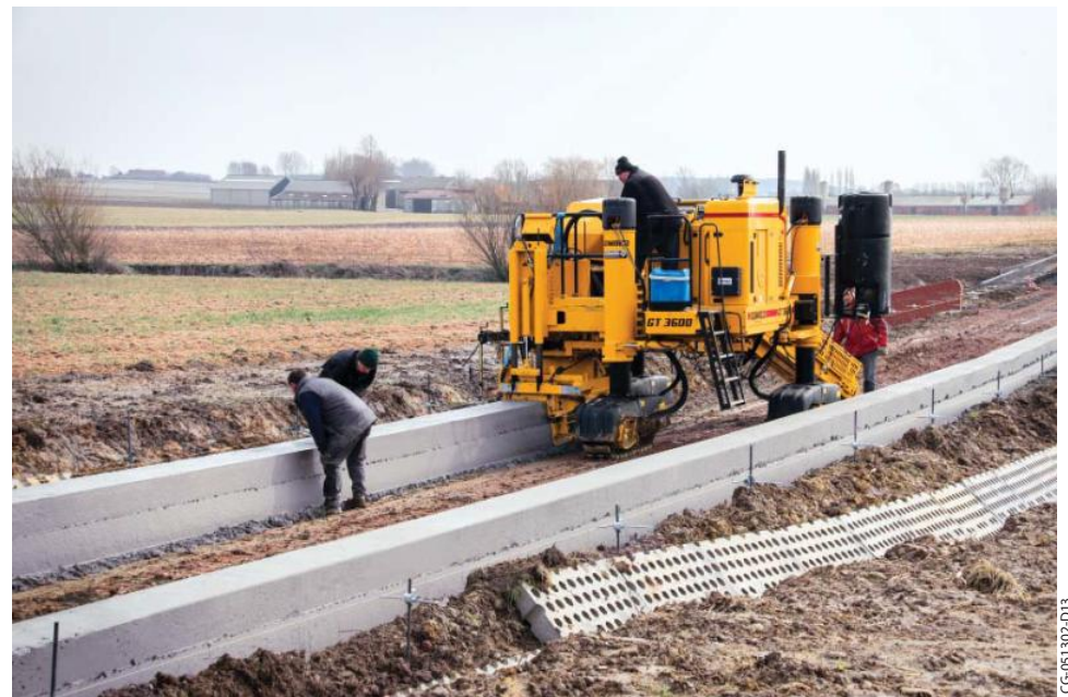
このGT-3600は、ベルギーの小さな村にて洪水防御バリアを打設しています。
