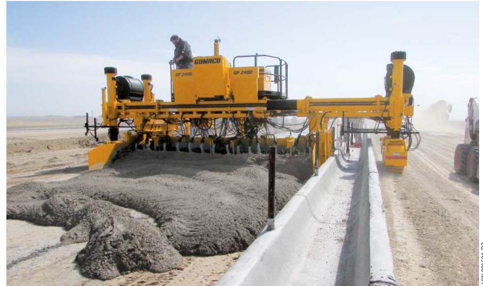
2トラックGP-2400が既存の乳牛用の給餌台の横に搾乳台を打設しています。左側のエンドフレームとレッグは給餌台を跨ぎ、グレード用のソニックセンサーが使用されています。
