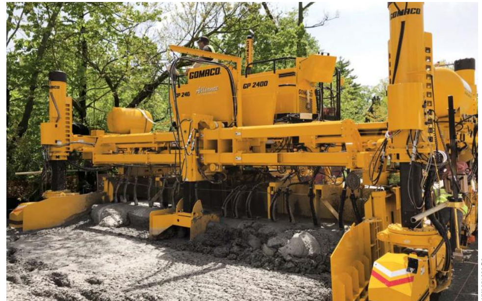
既存の木々が、この4トラックGP-2400の狭いクリアランスの状態を作り出しています。このペーパーは5000シリーズペービングモールドを搭載しており、前方にあるスプレッダープラウがコンクリートの高さを均しています。
