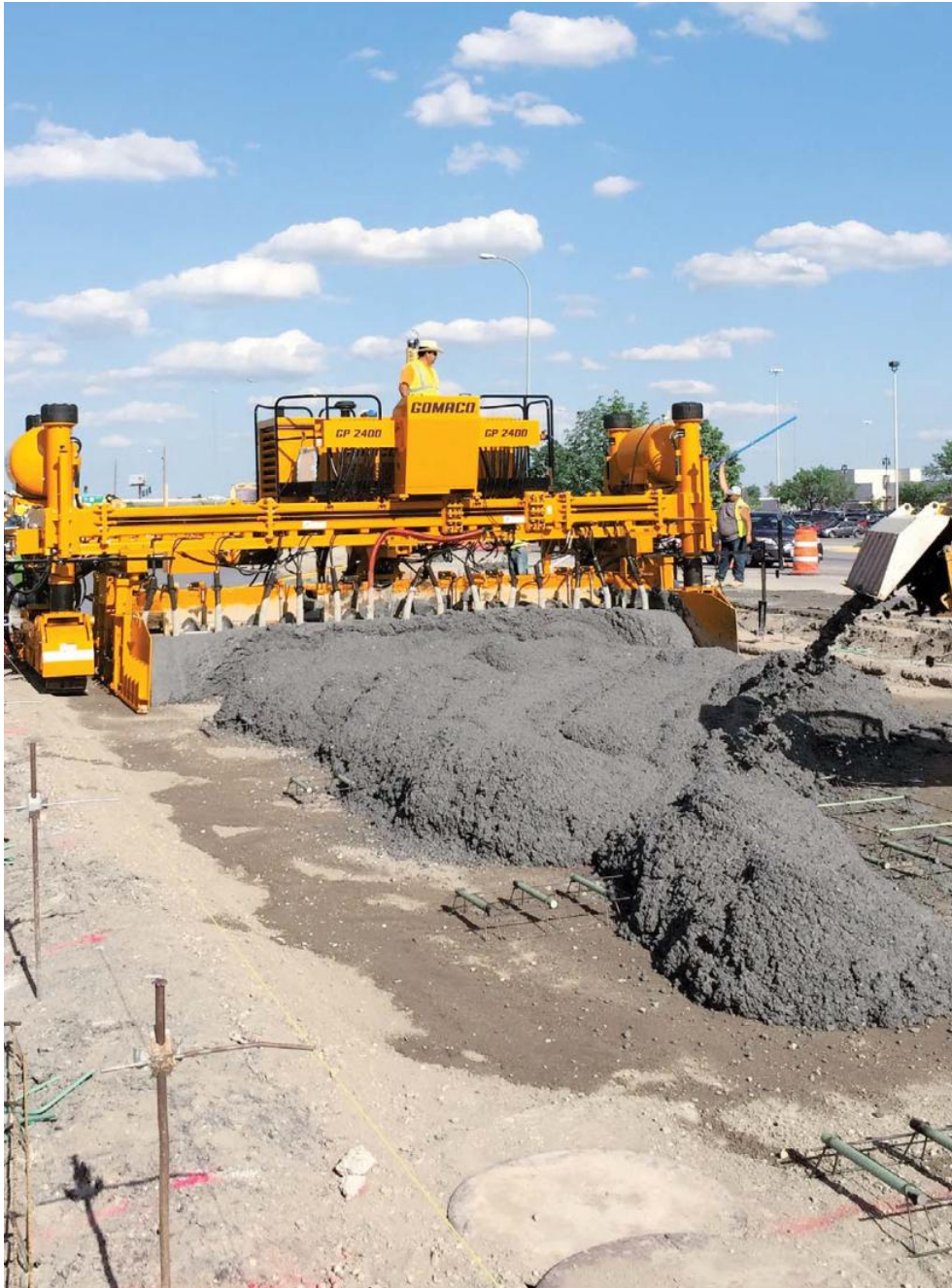
2トラックGP-2400が新しい市道を打設している前で、RTP-500がダウエルバスケットの上にコンクリートを配置しています。
