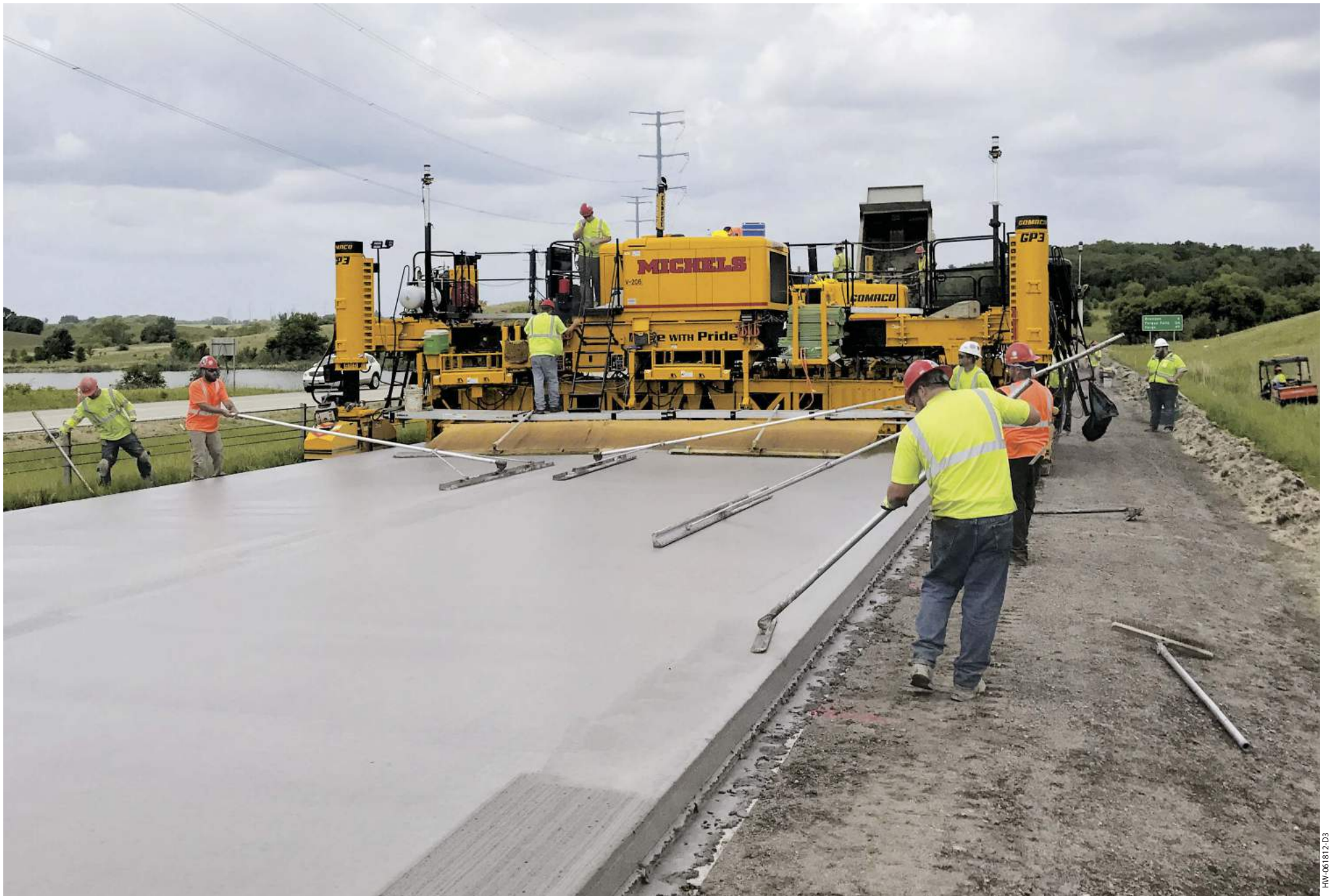
5400シリーズパーインサーターを装備したこの4トラックGP3は、州間高速道路の建設現場にて施工を行っています。5400シリーズパーインサーターは、素早く簡単にアクセスできる後方供給型です。
