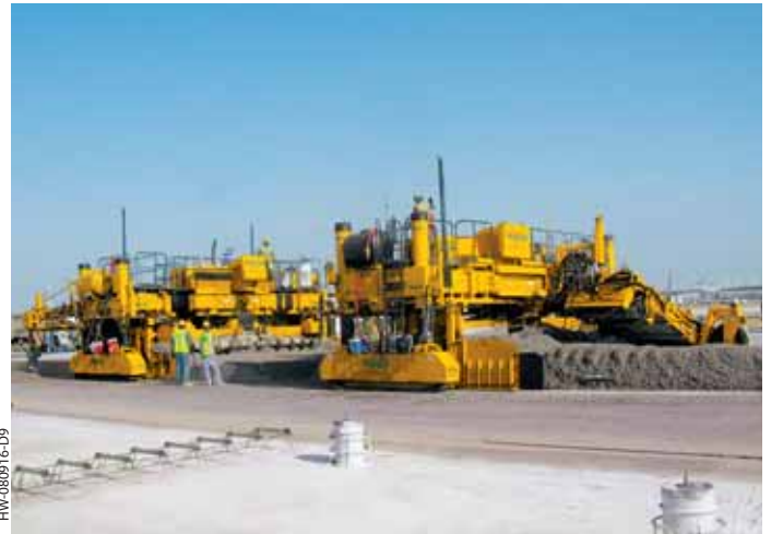
GOMACO PS-2600とGHP-2800は、空港にてペービングトレインを編成しています。この滑走路の舗装幅は25フィート(7.62m)です。
